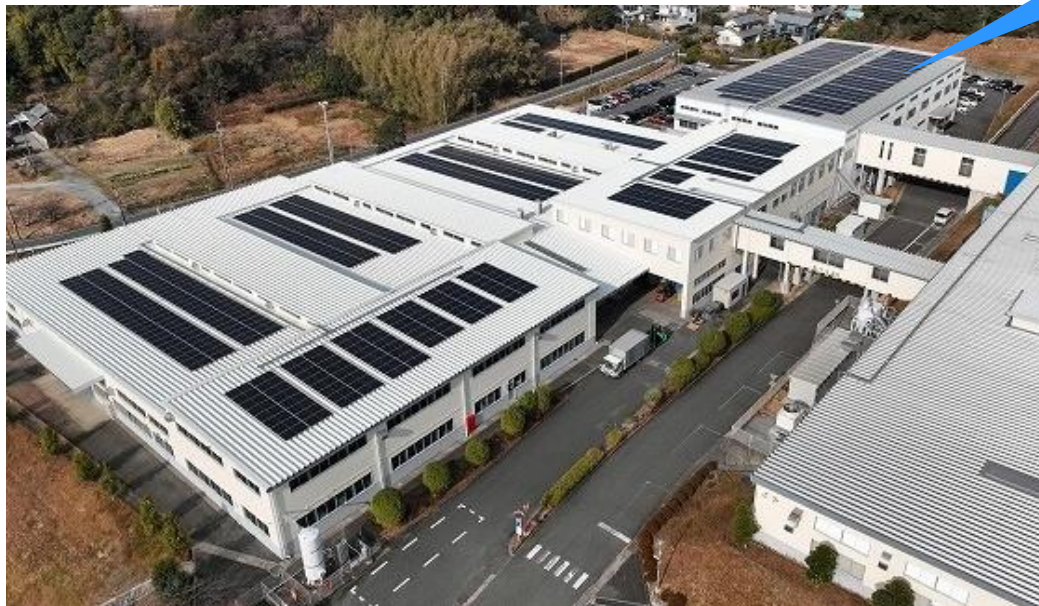
本社工場に設置した太陽光パネル
